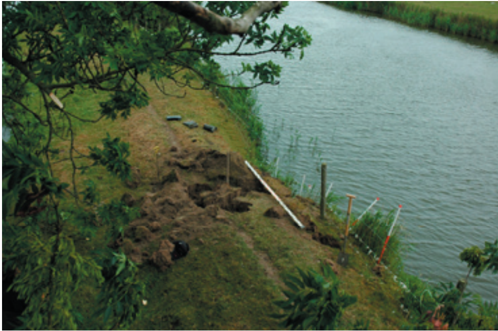
VOORBEELD VAN DE OMVANG VAN SCHADE DOOR GRAVERIJ DOOR MUSKUSRATTEN
