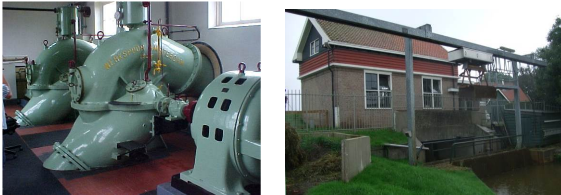
Figuur B4.26 Horstermeergemaal (op de linkerfoto de pompen en op de rechterfoto de buitenkant van het gemaal).
