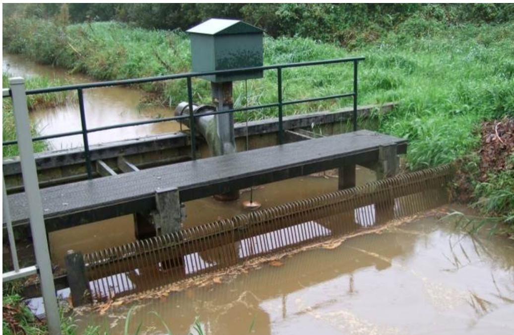
Figuur B4.10 Boostergemaal in de zuidelijke watergang langs de Radioweg.
